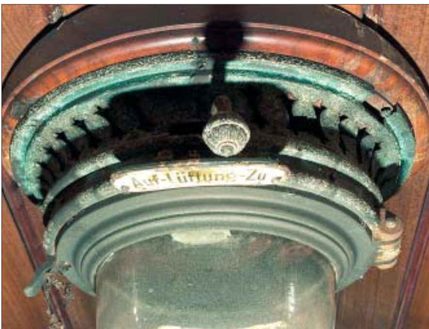
▲ Lampe im Flur. Deutlich sind die Korrosionsschäden zu sehen. Foto: C. Kirchner, DTM
